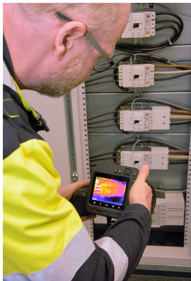
Med avansert termografisk kamera jakter Lasse Braadland på mulige brannfeller i elektriske anlegg. Her ser alt ut til å være i orden.
